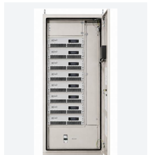
컨트롤 패널 내 다단 설치 예
