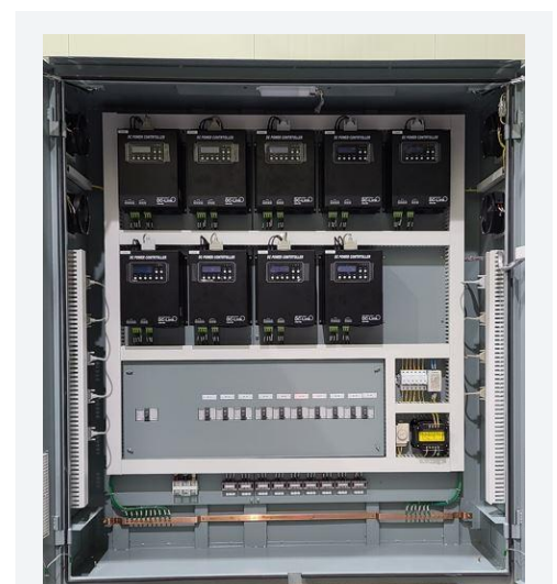
패널 내부 설치 예
